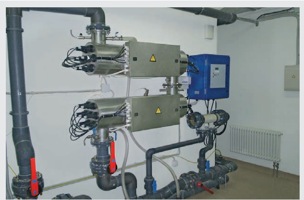
Частный бассейн, г. Москва, 100 м 3 /ч
