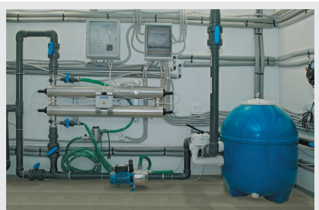
Частный бассейн, г. Москва, 10 м 3 /ч
